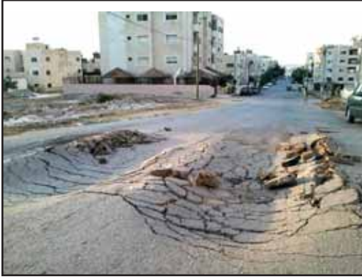
الشكلُ (٦-١): عدمُ صلاحيةِ الطريقِ.
