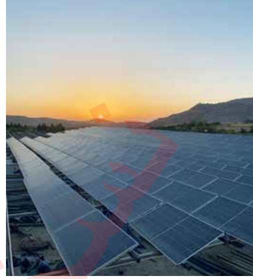
الشكل (13): إحدى محطات الطاقة الشمسية لتوليد الكهرباء في العقبة.
